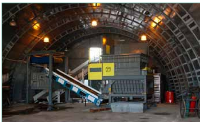
Участок подготовки отходов
